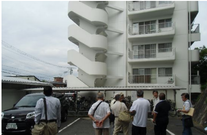
外階段に付けられた耐震補強の支柱を見学する参加者
